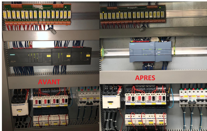
FIGURE 3.1 – Photo avant/après de l'armoire avec l'automate Siemens
